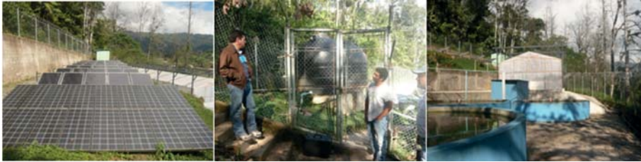
Figura 3.- Captadores solares térmicos y fotovoltaicos, acumulación de agua y estanquería de agua fría y caliente.
