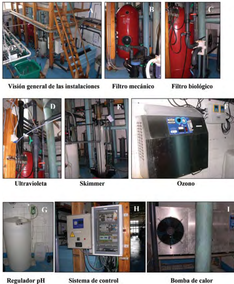
Figura 1.- Componentes del sistema de circuito cerrado. A , visión general de las instalaciones; B , filtro mecánico; C , filtro biológico; D , ultravioleta; E , skimmer; F , equipo de ozono; G , regulador de pH; H , sistema de control; I , bomba de calor.
